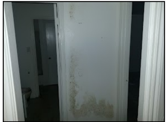
22 : Unit 3126 mold adjacent hallway
