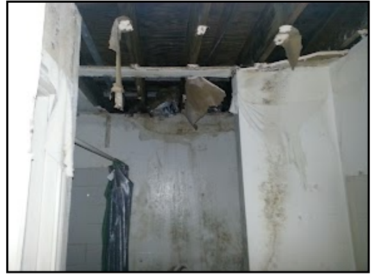
20 : Unit 3126 mold bathroom
